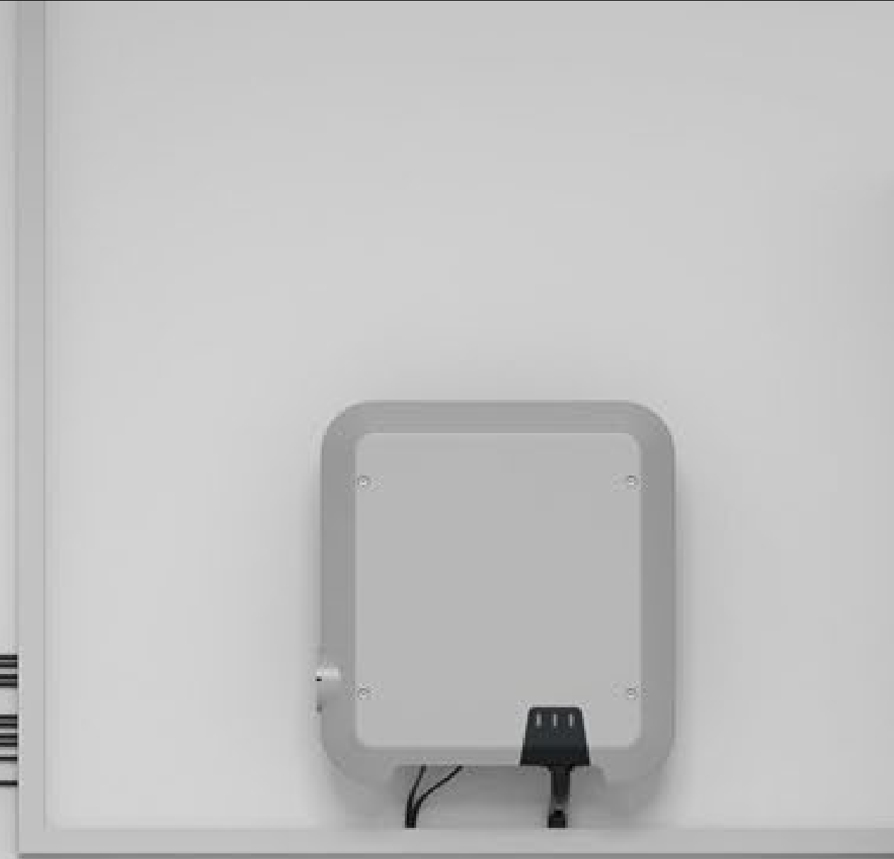
Vorhandener String- Wechselrichter eines Drittanbieters
