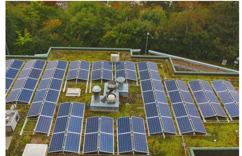
Foto: PV-Anlage auf Gründach mit relativ dichter Belegung
