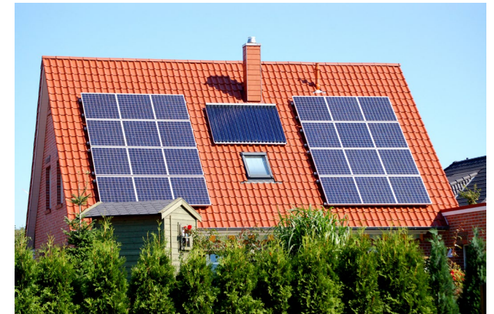
Foto: Einfamilienhaus mit PV-Anlage (rechts und links) und Solarthermie-Kollektor (Mitte)
