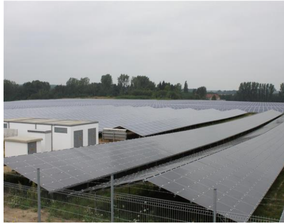
Staats; 39676 Stendal BJ 2012: Bauart Stringwechselrichter mit AC Verteilern und Feldtrafos, 13,54 MWp
