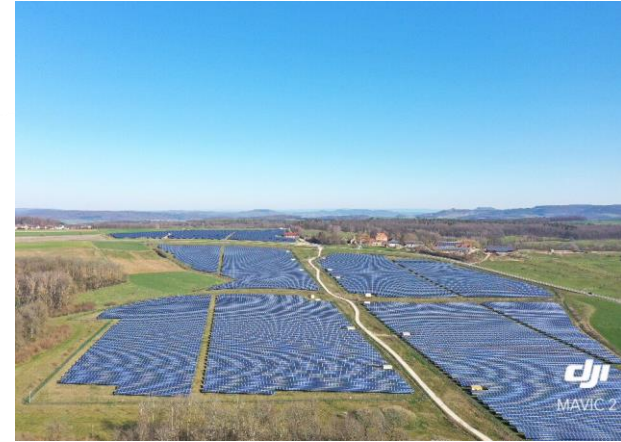
Gut Leimershof I, 96149 Breitengüßbach BJ 2010: Bauart Zentralwechselrichter mit Gaks; 13,79 MWp
