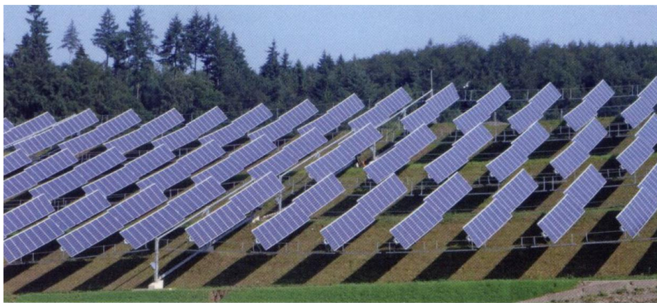
② Lonza Solarpark Waldshut-Tiengen mit 654 kW installierter Leistung
